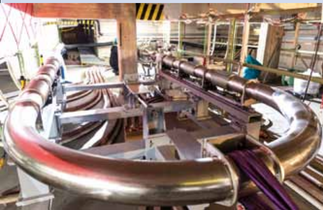
Test bestanden: Das keramische Supraleiterkabel am Umspannwerk Herkulesstraße in Essen hat über eine Rekordstrecke von einem Kilometer das Fünffache des herkömmlichen Stroms geleitet – fehlerfrei.
